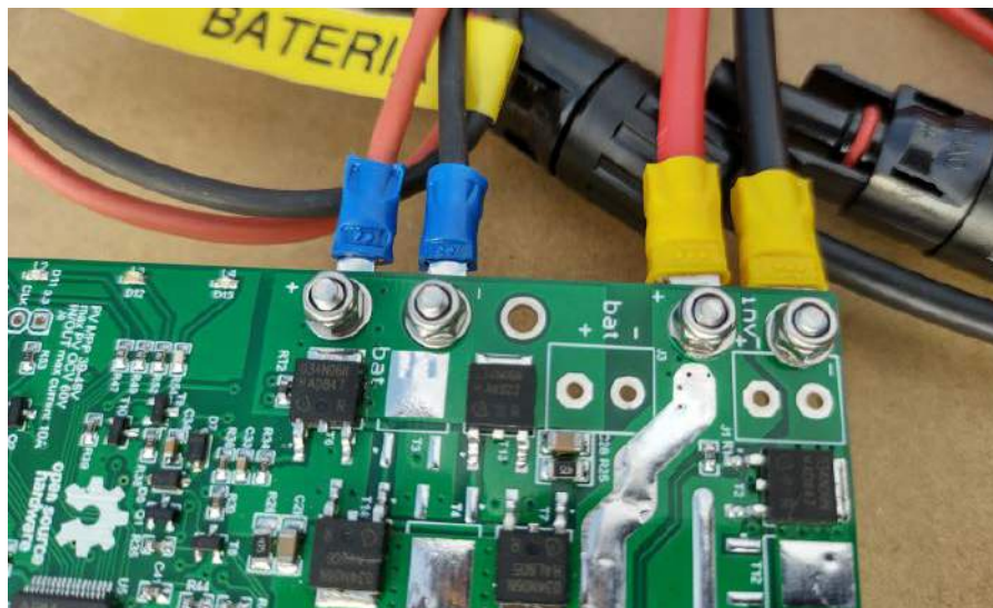
Fotografia 3. Połączenia przewodów wykonane przy użyciu końcówek oczkowych oraz śrubek M3 z nakrętkami samohamownymi
