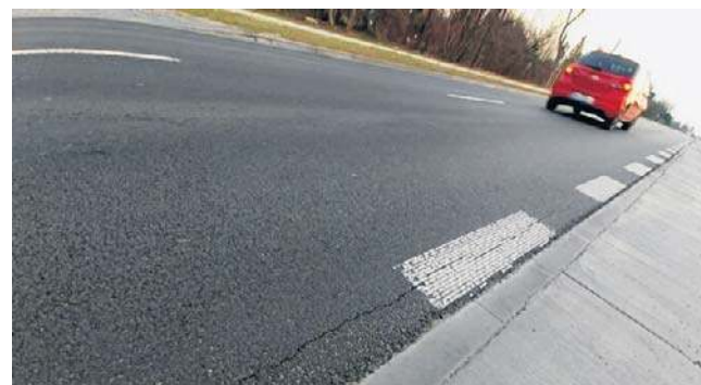
Na wyremontowanej nawierzchni ulicy Wolanowskiej w Radomiu już pojawiły się pęknięcia.
