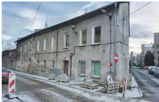
Budynek ze względu na zły stan nie jest użytkowany od ponad 4 lat
