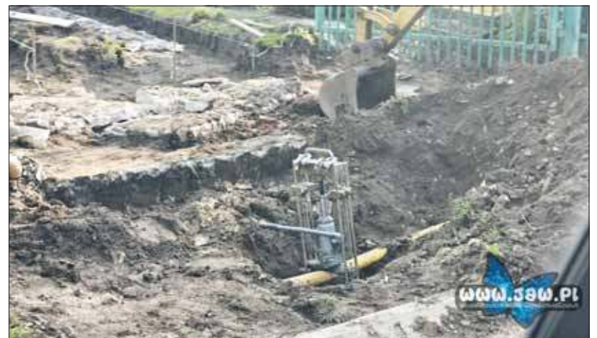
Uszkodzony gazociąg na ulicy Chrzanowskiej
