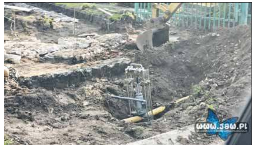
Uszkodzony gazociąg na ulicy Chrzanowskiej
