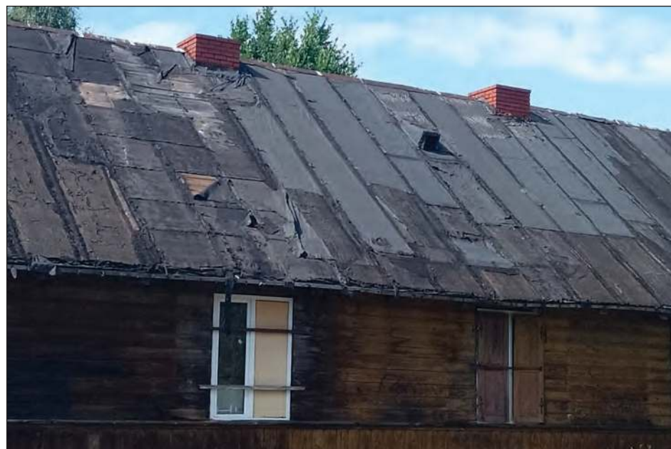
■ Po kilku latach od doraźnego remontu dach ponownie wymaga modernizacji. Towarzystwo Przyjaciół Dęblina uruchomiło subkonto i zwraca się do mieszkańców o dobrowolne wpłaty
