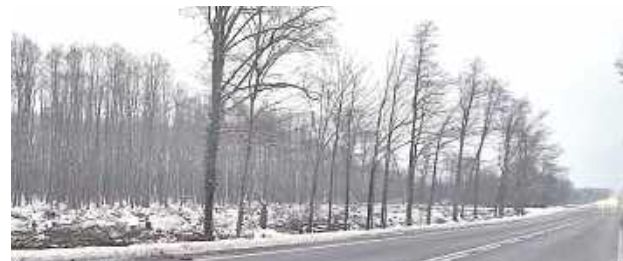
Rozpoczął się wyręb lasu pod budowę drogi ekspresowej S19. Szykowane jest miejsce na drugi pas ekspresówki, drogę dojazdową, przejścia dla zwierząt. Zostanie zniwelowany teren o szerokości ok. 40 metrów, w niektórych odcinkach nawet o 70 metrów
