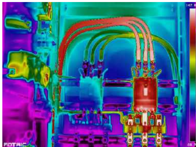
Fotografia 7. Obraz termowizyjny instalacji elektrycznej
