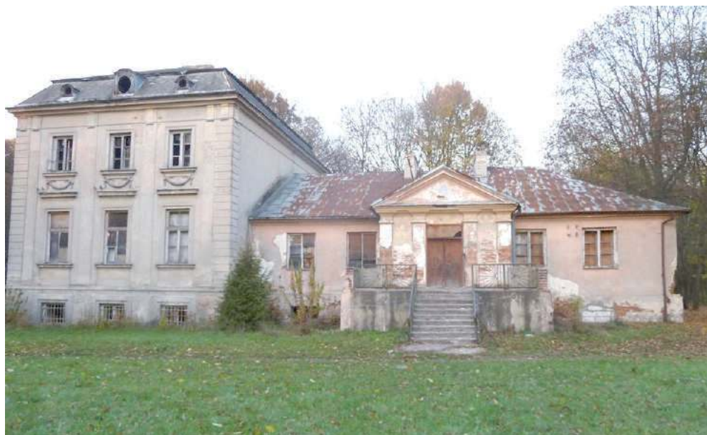
Dziś zabytkowy budynek jest w opłakanym stanie i służy za miejsce spotkań, które z kulturą mają niewiele wspólnego
