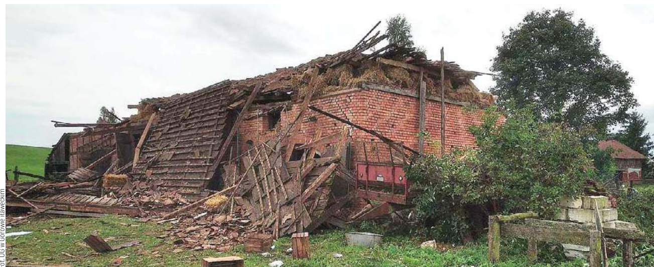
Tak wyglądały budynki tuż po przejściu trąby powietrznej
