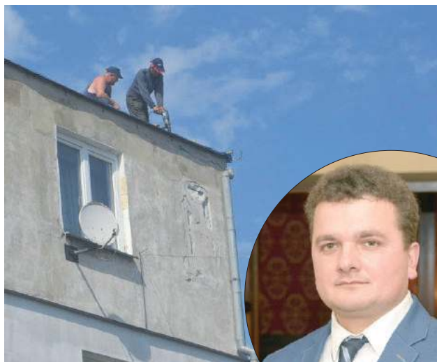
Łukasz Kłębek: Łącznie jest 50 uszkodzonych budynków, w tym 15 mieszkalnych. Dobrze, że chociaż część mieszkańców miała je ubezpieczone.
