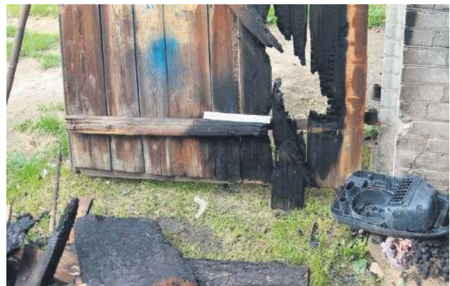
Ogień strawił frontową ścianę budynku oraz fragmenty konstrukcji dachu. Na szczęście w pożarze nikt nie ucierpiał. Fot. KMP Zamość
