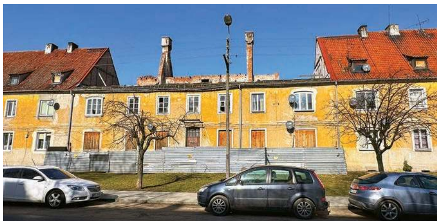
Ul. Traugutta - wyłączona z użytku część budynku mieszkalnego
