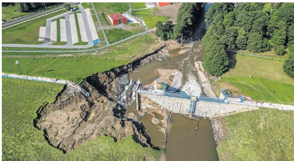
Tyle zostało ze zbiornika po przejściu wielkiej wody we wrześniu 2024 roku. Zapora uległa potędze żywiołu
