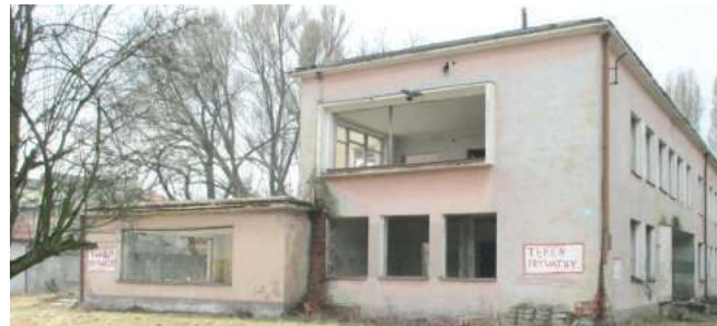
Ruiny żłobka znajdują się w samym centrum Lubartowa. Zbierają się w nich miłośnicy mocnych trunków
