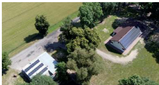
Instalacja fotowoltaiczna na budynku Świetlicy Wiejskiej i OSP w Gęsi
