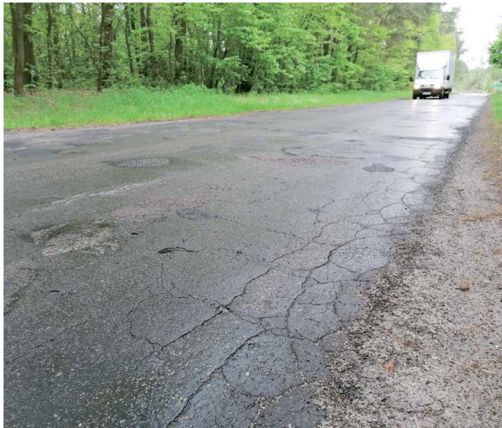
Droga powiatowa Chodel - Poniatowa jest w opłakanym stanie. Popękana, zdeformowana, z wybojami i koleinami. Doraźne działania drogowców to za mało. Droga potrzebuje gruntownej przebudowy, zanim rozsypie się w drobny mak. W najgorszym stanie jest odcinek z Dąbrowy do Siewalki. Robiony był w latach 70.
