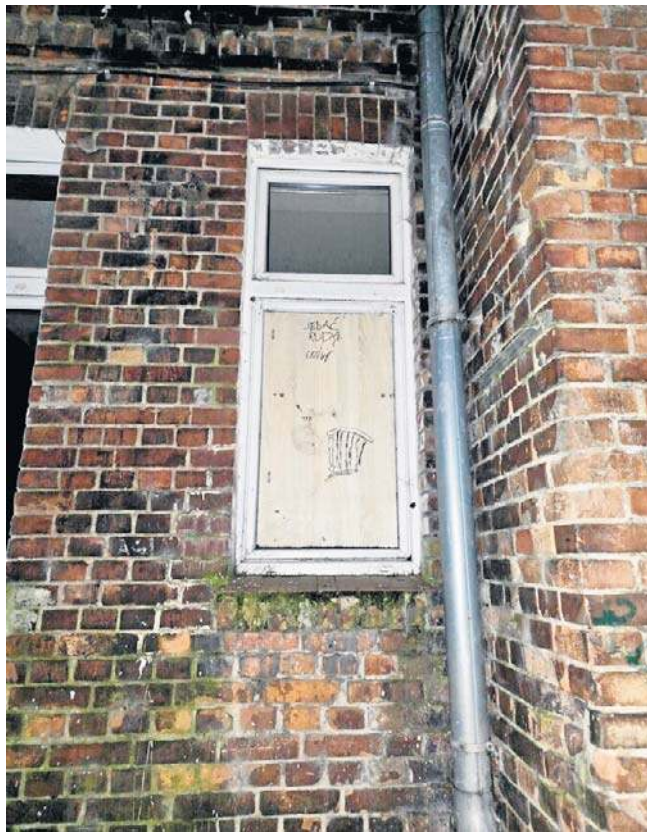
W niektórych budynkach okna zostały już dawno wybite - zastąpiono je dyktą
