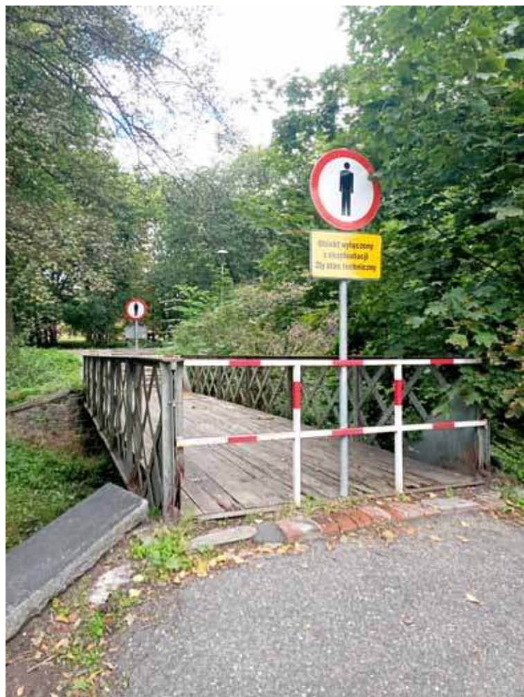
Mieszkańcy czekają na remont kładki. Zdjęcie sprzed tygodnia
