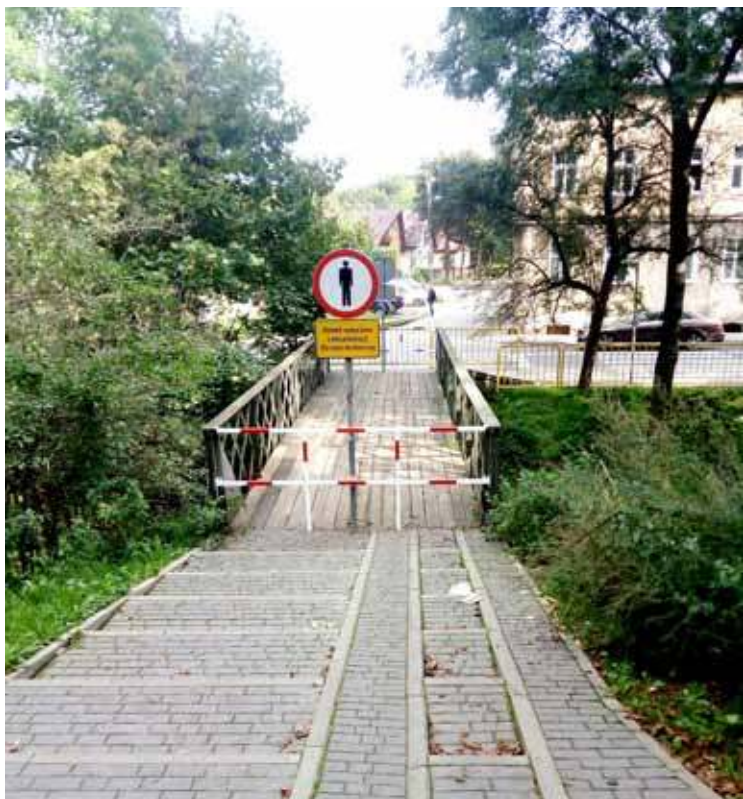
Kładka jest od dawna zamknięta dla użytkowników. Zdjęcie sprzed dwóch lat
