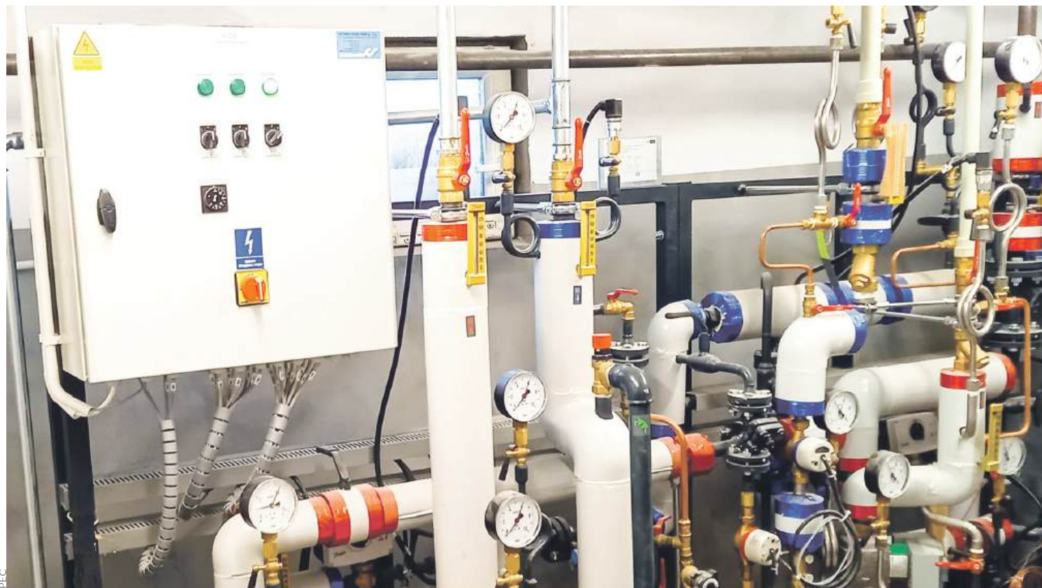
Węzeł ciepłowniczy PEC
