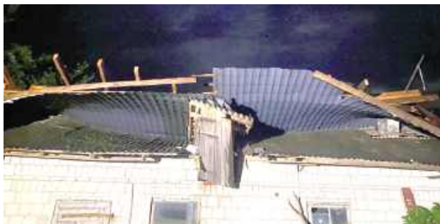
Wiele dachów na budynkach gospodarczych zostało uszkodzonych przez wiatr
