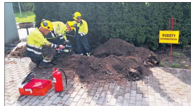
Przy ul. Koncertowej doszło do wycieku gazu, w związku z tym na miejsce przybyło sześć zastępów straży pożarnej i pogotowie gazownicze. Doszło do ewakuacji mieszkańców
