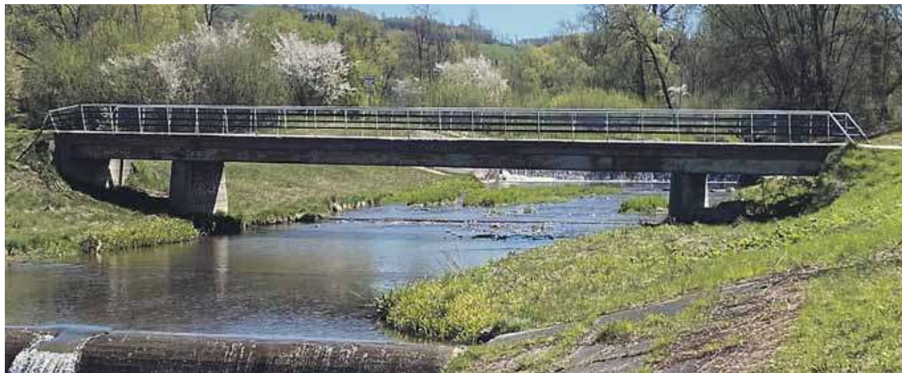
Stary most na Poniczance jest w fatalnym stanie technicznym.
