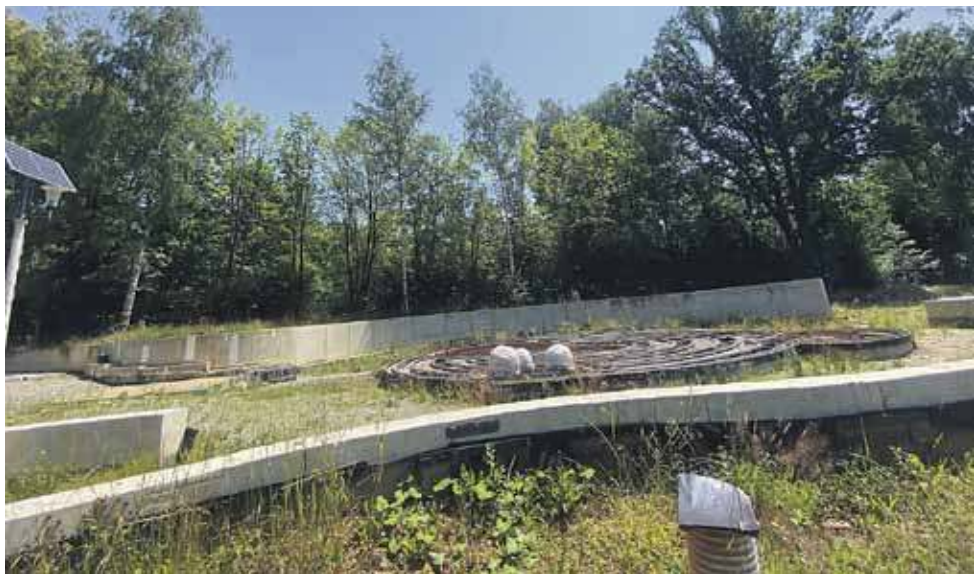
Główna płyta placu wodnego ma poważne pęknięcia.
