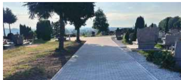
Zakończył się ostatni etap budowy chodników z kostki brukowej na cmentarzu parafialnym w Przewornie
