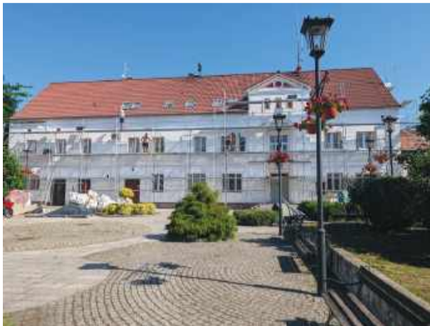
Na budynku urzędu prowadzone są prace związane z dociepleniem i nową elewacją
