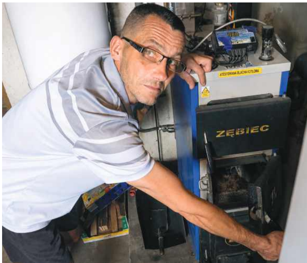
– Oba piece stoją zaledwie 30 centymetrów od siebie. Mam problem z czyszczeniem urządzenia i podkładaniem węgla – przekonuje pan Marek
