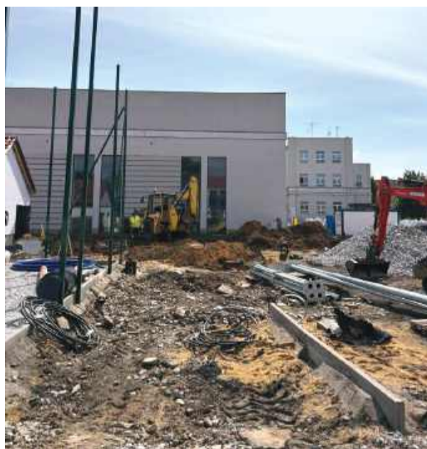
Obecnie teren przy strzelińskim liceum jest placem budowy. Niedługo powstanie tutaj nowoczesne boisko wielofunkcyjne
