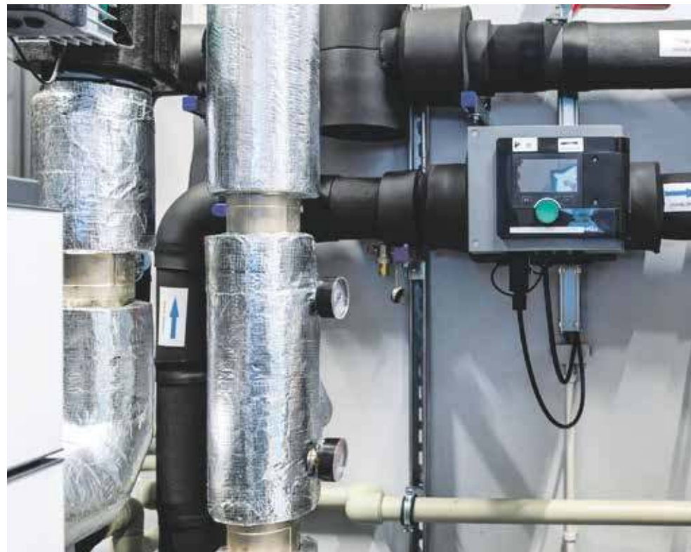
System ogrzewania budynku jest nowoczesny i bardzo wydajny
