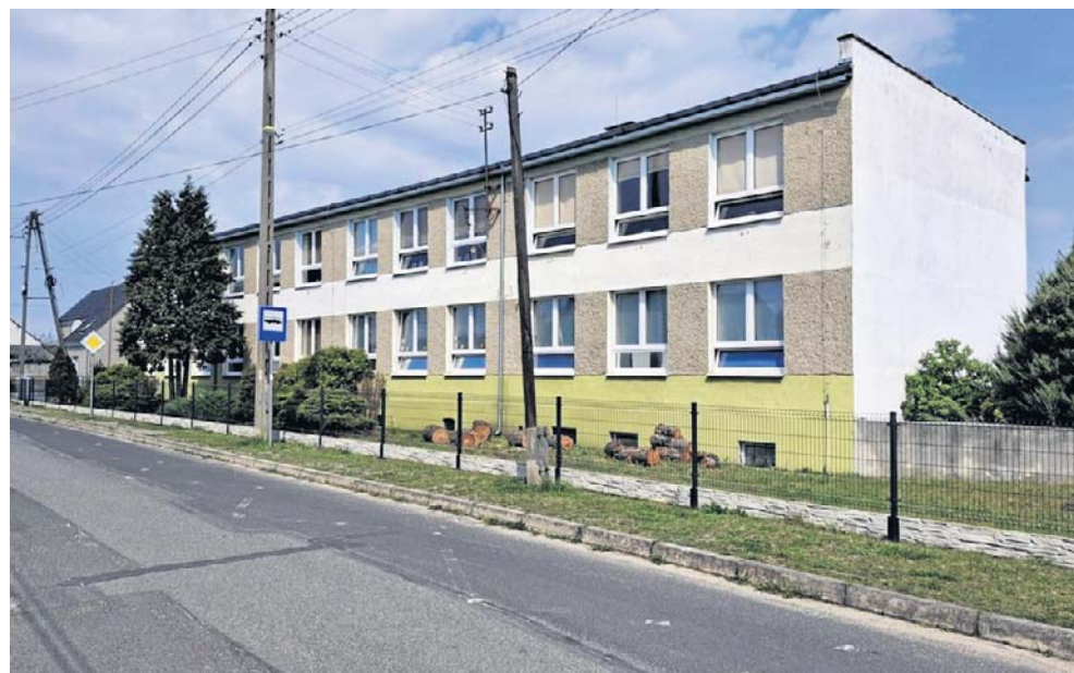
Lekcje odbywają się mimo remontu. Jedno piętro zostało wyłączone z użytkowania. Na remont pozyskano ponad milion złotych unijnego wsparcia
