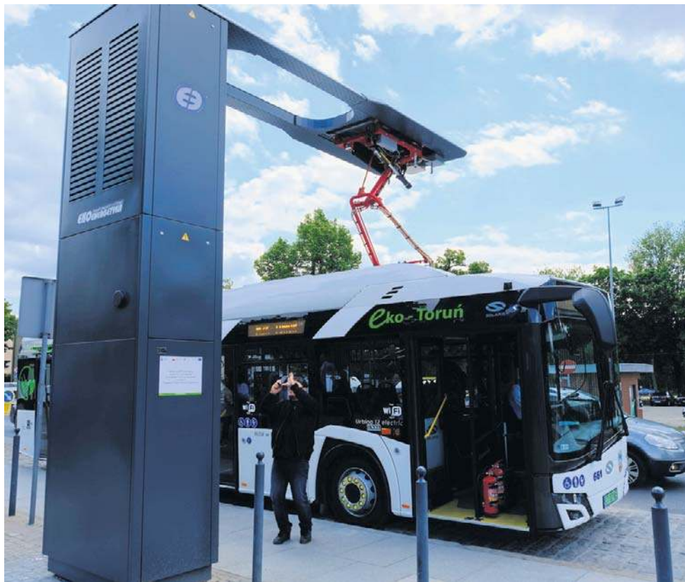
W ramach projektu, na pętach staną szybkie ładowarki, a w zajezdni podwójne ładowarki wolnego ładowania. Na zdjęciu ładowarka na pl. św. Katarzyny
