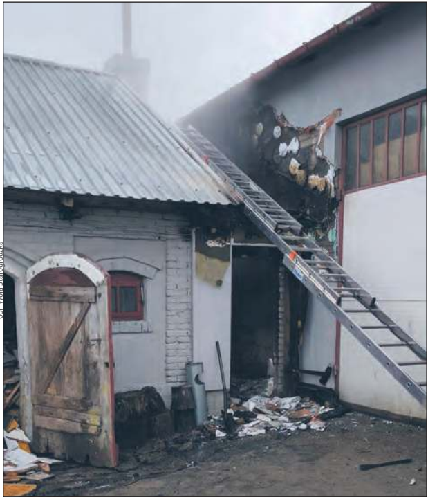
Siedem zastępów straży pożarnej brało udział w gaszeniu pożaru kotłowni w miejscowości Żelazna
