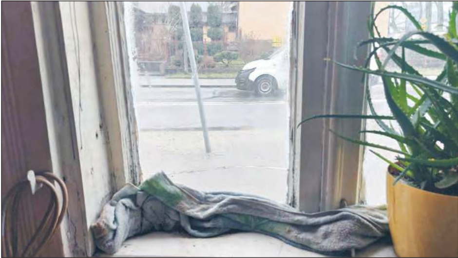
» Okna są nieszczelne. Leci przez nie zimno. W jednym z nich, akurat przy łóżku dziecka, jest pęknięta szyba
