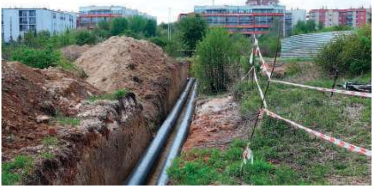
W ostatnich 10 latach do sieci ciepła systemowego LPEC przyłączył, aż 530 obiektów o łącznej powierzchni 2 mln mkw
