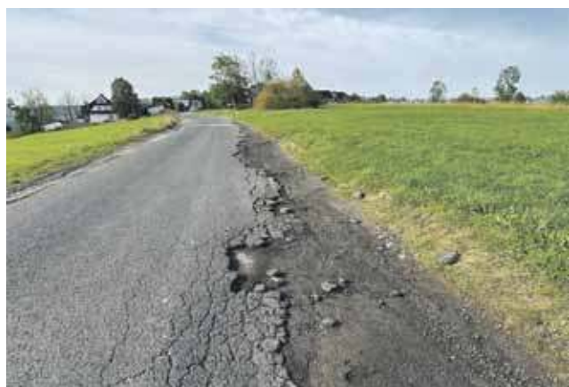
Droga jest w katastrofalnym stanie.
