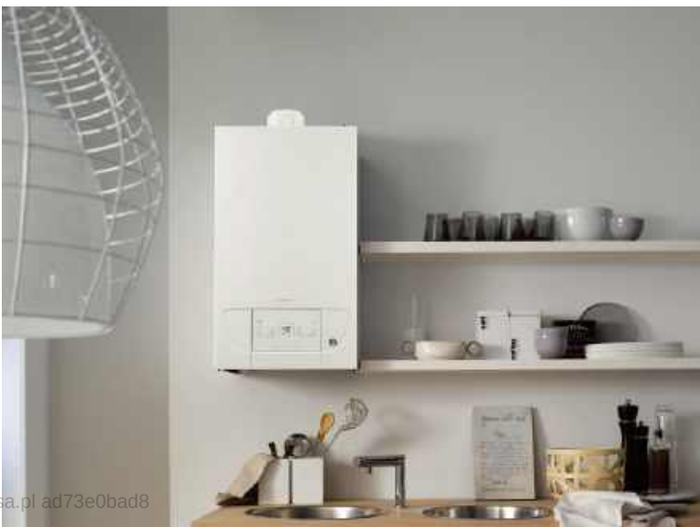
🔥 Kocioł gazowy w kuchni lub łazience to chętnie stosowany i sprawdzony wariant. Wygospodarowanie kotłowni nie jest niezbędne. DE DIETRICH
