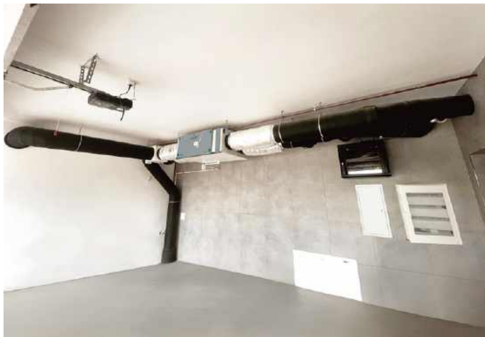
➊ Rekuperację najlepiej zaplanować podczas budowy domu, gdy najłatwiej jest ukryć kanały wentylacyjne – w wylewkach podłogowych, w stropie czy pod sufitem. PRO-VENT
