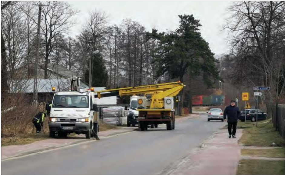
➤ Do groźnego zdarzenia doszło w sobotę po południu w centrum Leopoldowa (gm. Ryki). Na skrzyżowaniu ulic Ks. Drozdowskiego i Dworcowej powalone drzewo zerwało linię energetyczną. Przewody spadły na jezdnię
