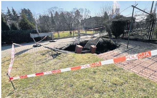
Dwa lata temu była w tym miejscu wizja lokalna, bo już wtedy mieszkańcy alarmowali, że teren się obniża
