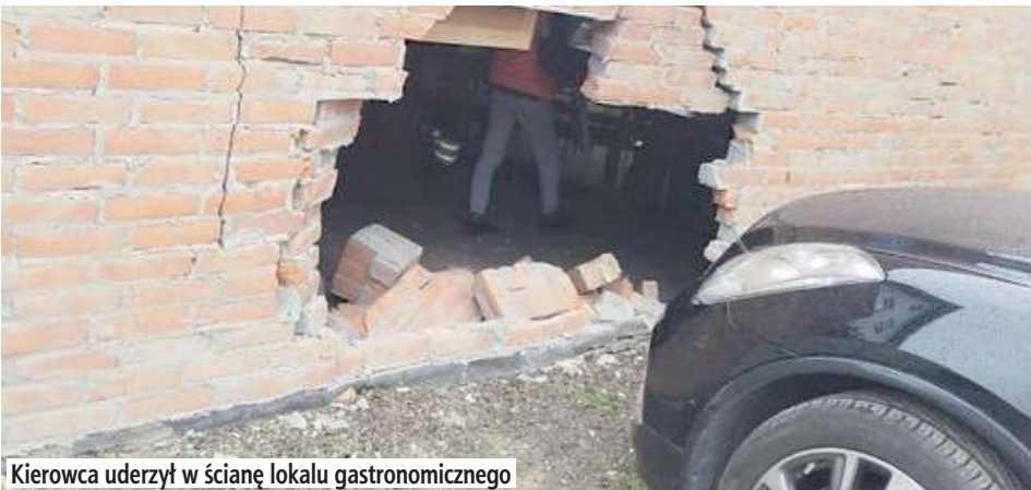
Kierowca uderzył w ścianę lokalu gastronomicznego
