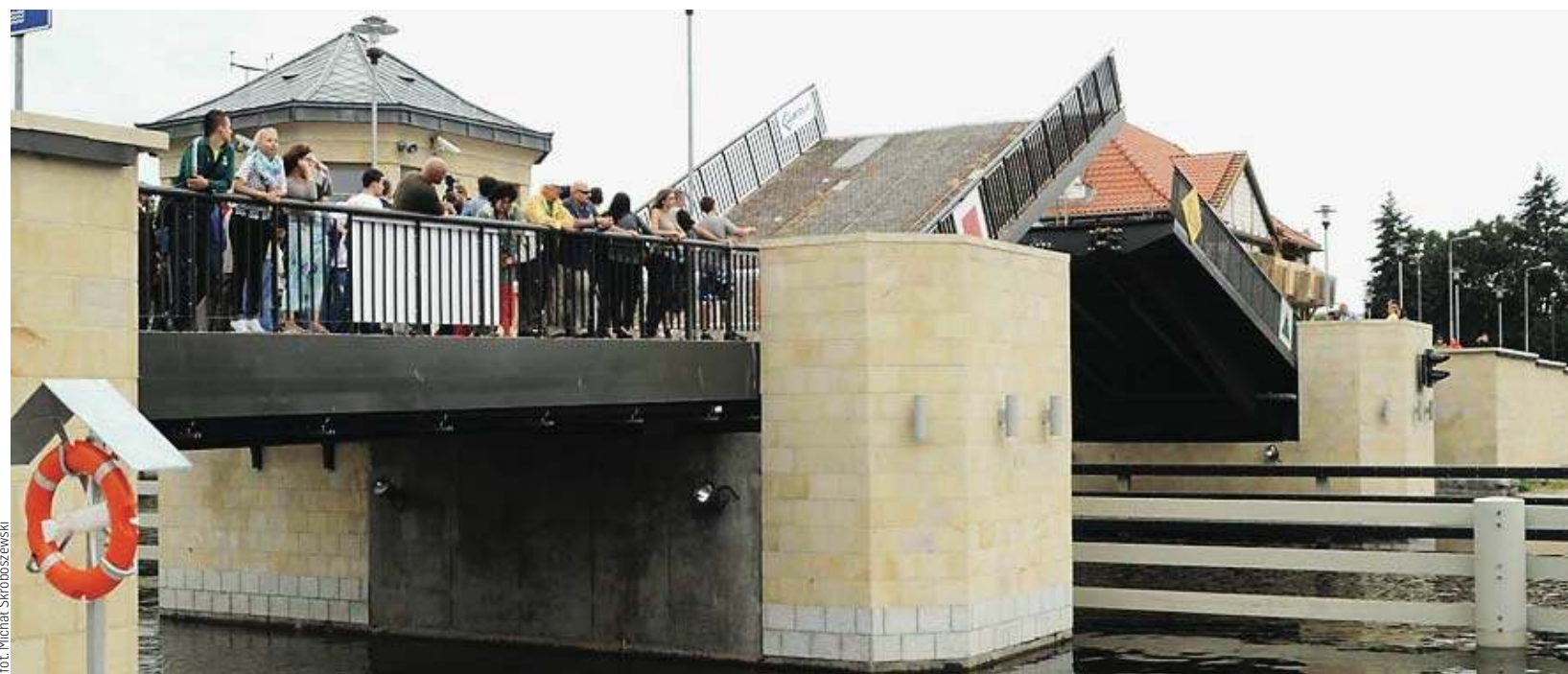
Mosty zwodzone oddano do użytkowania w 2013 roku. Niestety ich stan techniczny od początku stwarzał problemy
