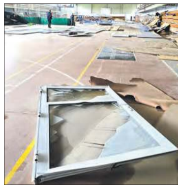
Zniszczone wnętrze hali przy ul. Łucznicznej w Prudniku
