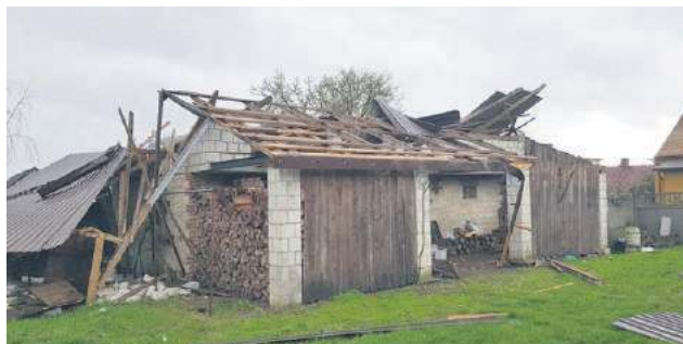
Wiele budynków gospodarczych zostało uszkodzonych.
