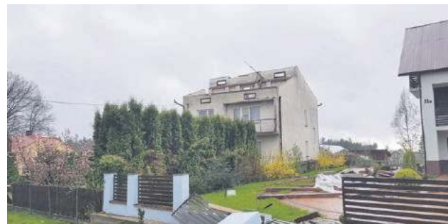
Budynek mieszkalny został bez pokrycia.
