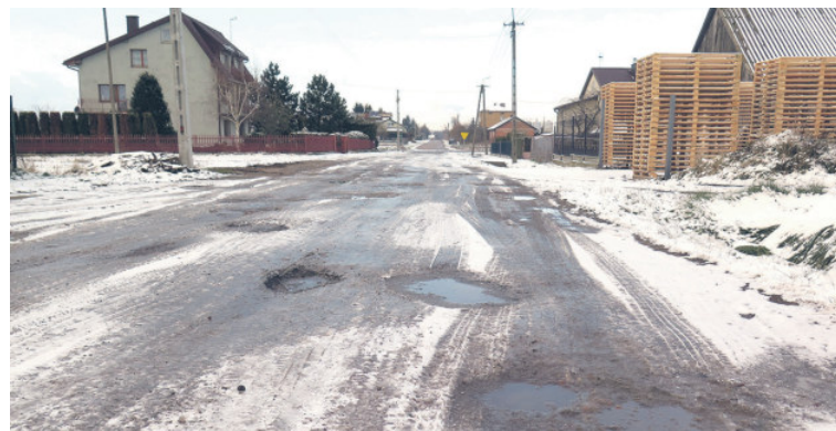
Ulica Klonowa na 850 m jest nieutwardzona i pełna olbrzymich dziur.
