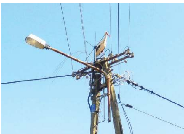
Mieszkańcy Firleja są poruszeni likwidacją bocianiego gniazda w tej miejscowości. Gniazdo znajduje się na rogu ul. Cmentarnej i Willowej. Bociany gniazdują na słupie energetycznym
