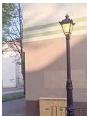
Świecące w dzień lampy to efekt działalności osób nieuprawnionych, które manipulowały ustawieniami skrzynki energetycznej
