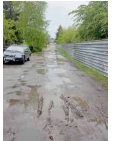
Kaluża na kaluży. Dla pieszego przejścia w zasadzie nie ma
