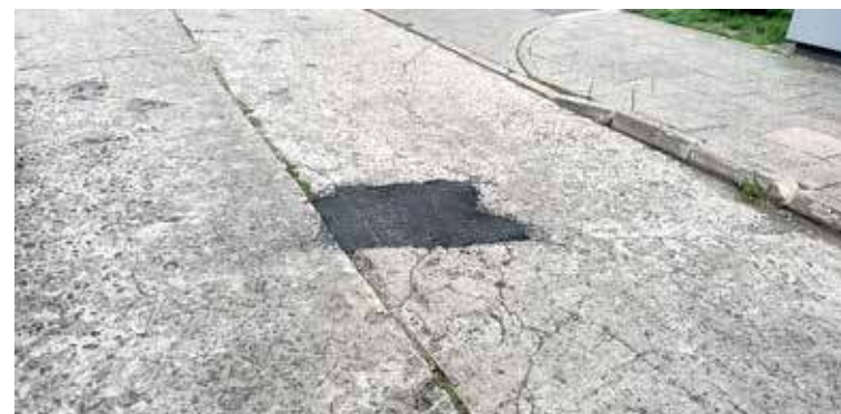
Jedna ze świeżych asfaltowych łat
