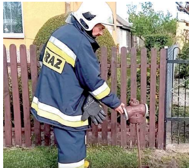
Strażak OSP pokazuje zardzewiały hydrant
