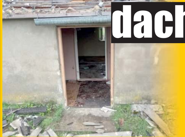
Pan Józef przebywa aktualnie w szpitalu, jego bliscy zaczynają odbudowę domu
