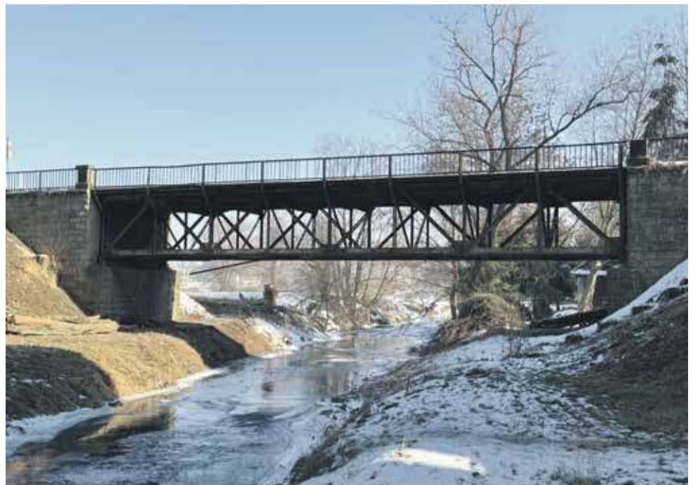
Stary most o konstrukcji stalowej jest w tragicznym stanie technicznym.
