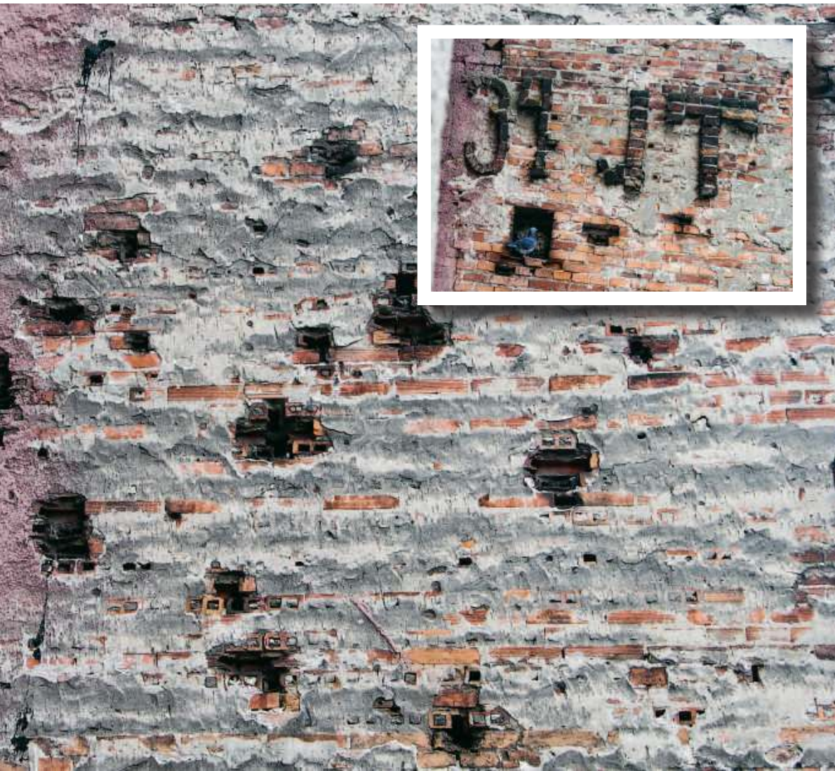
Fragment daty wraz z inicjałami właściciela na ścianie szczytowej kamienicy oraz ślady ostrzału z 1944 r. | fot. Janusz Sujecki/Gazeta Polska
