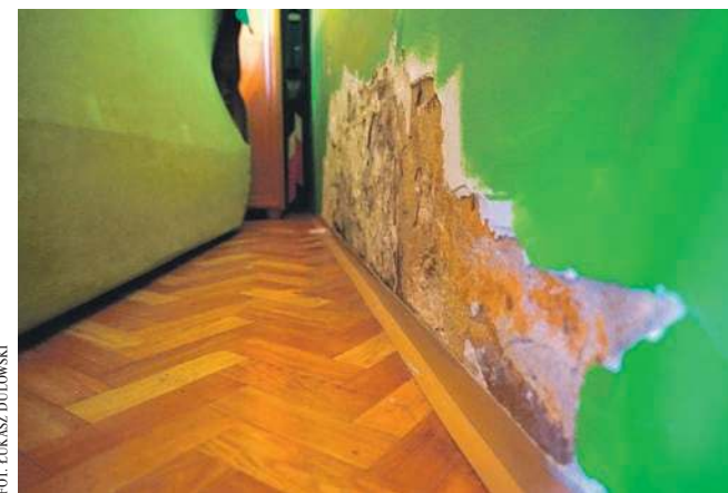
Tynk odpada od zawilgoconych ścian
