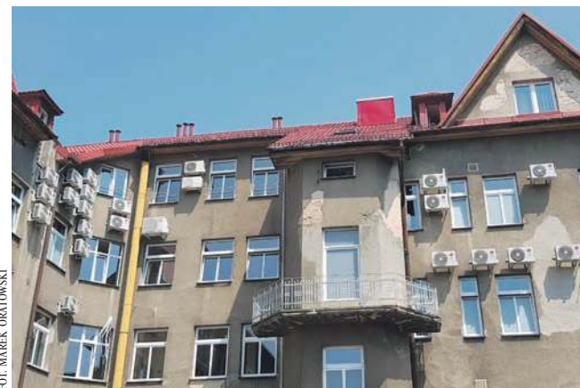
Bateria klimatyzatorów przy ulicy Sokola w Chrzanowie
