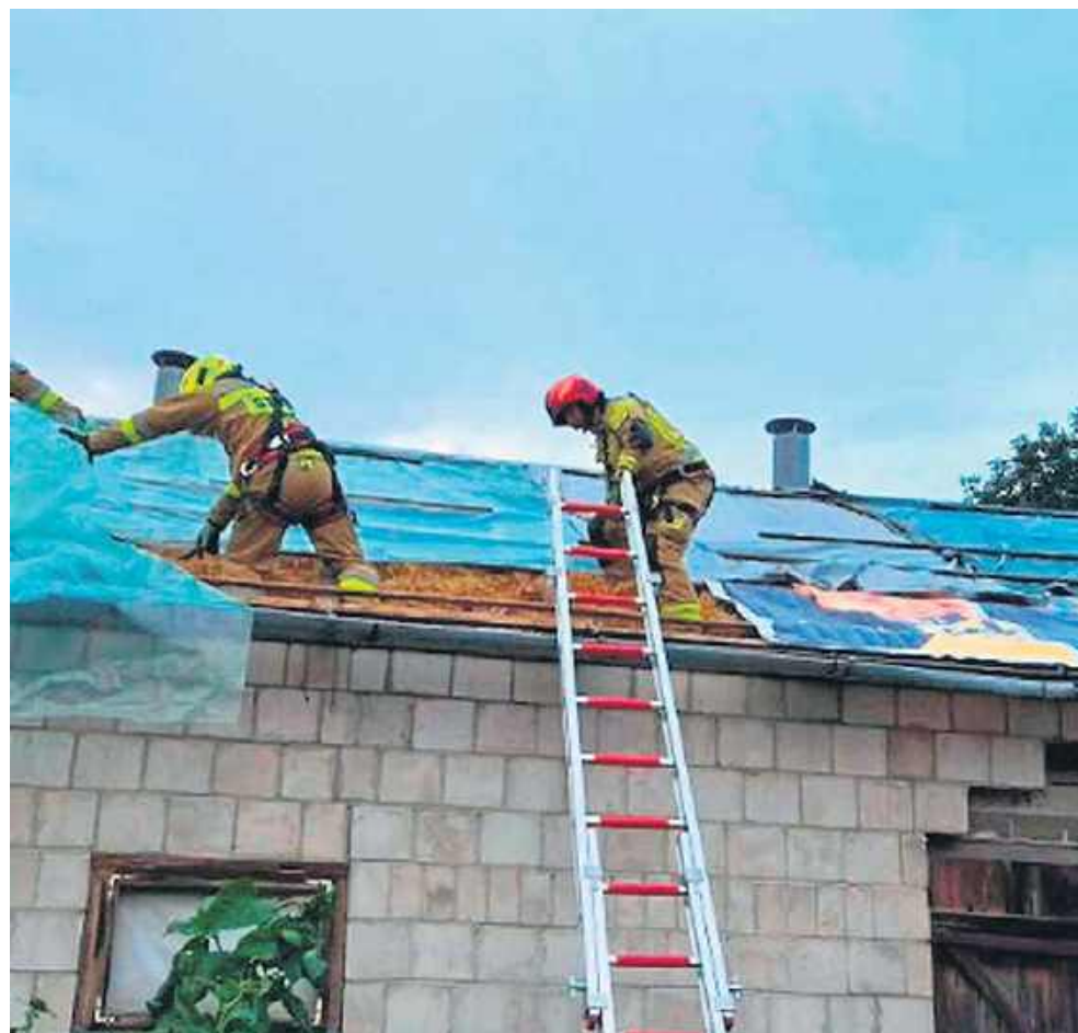
Po nawałnicy w powiecie strażacy zabezpieczali kilkanaście uszkodzonych dachów.
