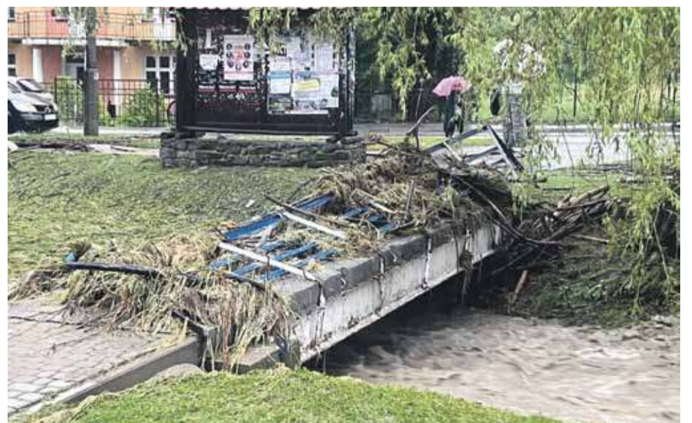
Kładki na Słonce zniszczyła gwałtowna powódź w lipcu 2023 roku.
