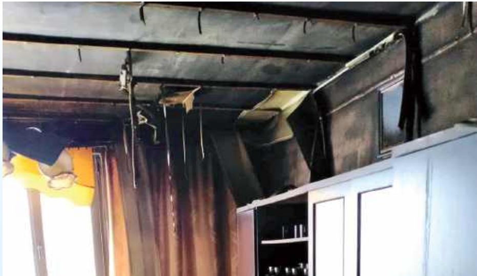
Uszkodzenia, jak widać, są znaczne, a koszt remontu przekracza możliwości finansowe pogorzelców i ich rodziny
