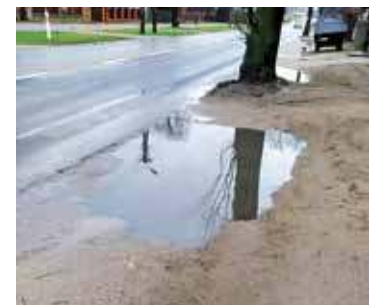
Spora kałuża pod którą znajduje się jedna ze studzienek kanalizacyjnych
