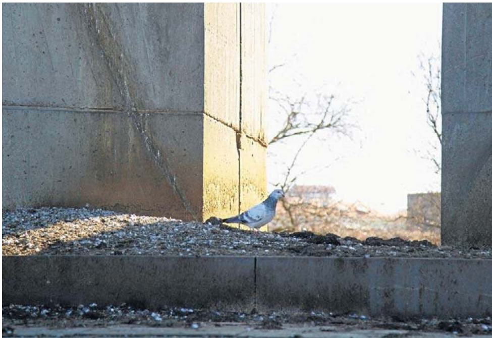
Nieuprzątnięty i popadający w ruinę pomnik
