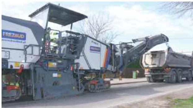
Remont drogi gminnej numer 105286L w Ciechankach Kolonii skupia się na odcinku liczącym dokładnie siedemset osiemdziesiąt pięć metrów
