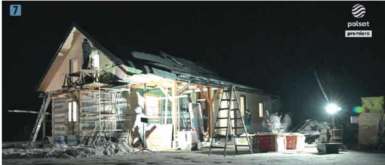
Zdj. Screen z odcinka. Ekipa remontowa kontynuowała prace także nocą, wskazując na duży zakres robót wynikający z liczby pomieszczeń w budynku. Szczególną uwagę zwrócili na konieczność odpowiedniego zabezpieczenia elewacji – zastosowano folię ochronną oraz nagrzewnice, aby umożliwić prowadzenie prac w niskich temperaturach. W ramach dostosowania przestrzeni do potrzeb najmłodszych mieszkańców domu zamontowali również oświetlenie nawet schodów
