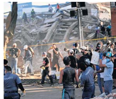
Wolontariusze i ratownicy szukają ocalałych w gruzach zawalonego budynku po trzęsieniu ziemi w Cali
